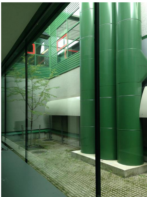
Ilmanvaihtokanavia johdettuina kellarin konehuoneesta sisäpihan kautta. Vierekkäiset vihreät peltikanavat sopivat koulun alkuperäiseen ilmeeseen paremmin kuin suuri kotelorakenne. Kuva: Sari Nieminen.
